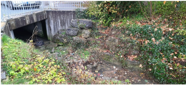
Abb. 10: Der Borrenbach ist teilweise verdolt und die offen liegenden Bereiche sind verbaut.
