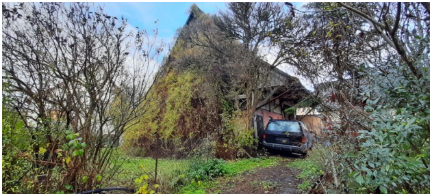
Abb. 17: Ehemals landwirtschaftlich genutztes Gebäude auf Flurstück Nr. 11. Bei diesem unbewohnten Gebäude mit Einflugmöglichkeiten durch zerbrochene Fenster und potenziell für Fledermäuse nutzbare Spaltenstrukturen besteht mittleres bis hohes Quartierpotenzial.
