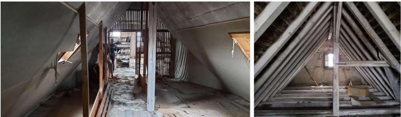
Abb. 14: Ehemals von Tauben genutzter Dachstuhl im Gebäude 1 an der Westseite des Gebäudes.
