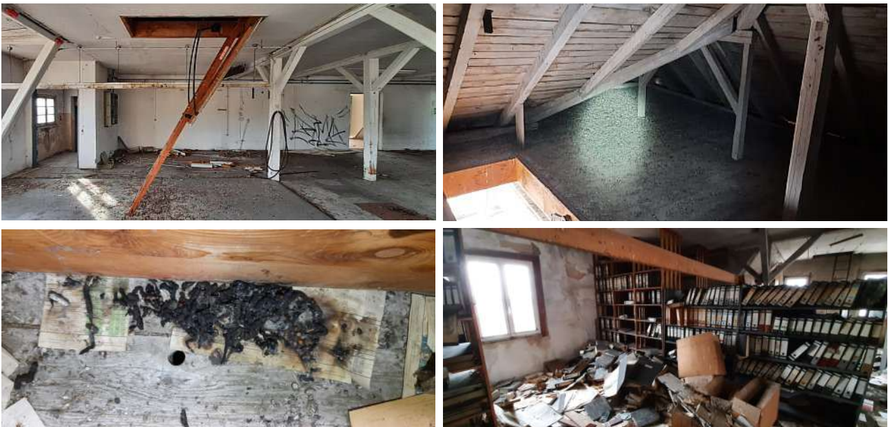
Abb. 27: Oben links: Dachluke mit Leiter in den Dachstuhl des Gebäudes auf Flurstück Nr. 2414/5 mit viel unterhalb gelegenen Taubenkot. Oben rechts: Ein Teil des Dachstuhls des Gebäudes auf Flurstück Nr. 2414/5 mit einer großen Ansammlung an Taubenkot. Hinweis einer Nutzung als Ruhestätte. Unten rechts: Dachgeschoss des angrenzenden Gebäudebestandes mit altem Aktenarchiv. In den Regalen und auf dem Boden konnten Altnester registriert werden, was für eine ehemalige Nutzung als Fortpflanzungsstätte spricht. Unten links: Alter Marderkot im Vorraum des Aktenarchivs als Nachweis einer Besiedlung des Gebäudes durch Prädatoren.
